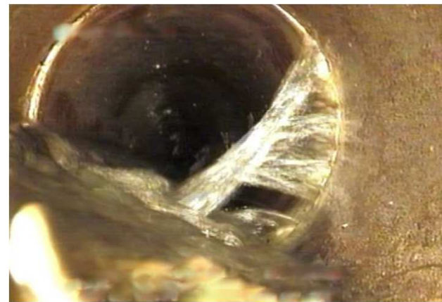
Infiltration durch eine Rohrmuffe
