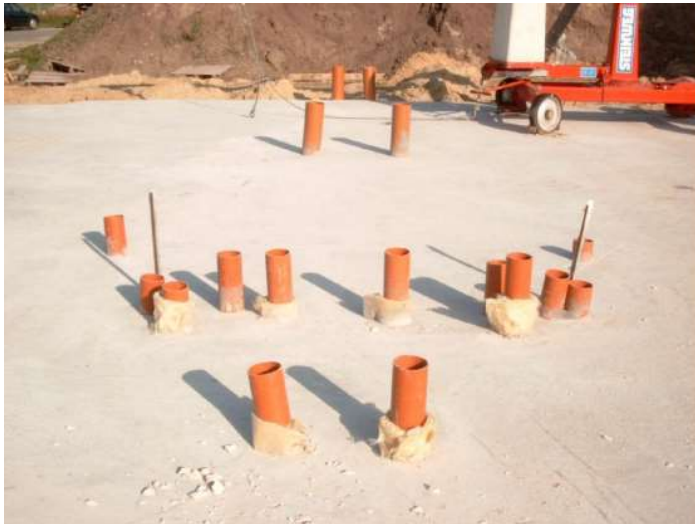
Bild 3: Problematisch KG-Rohre als Hauseinführungen
