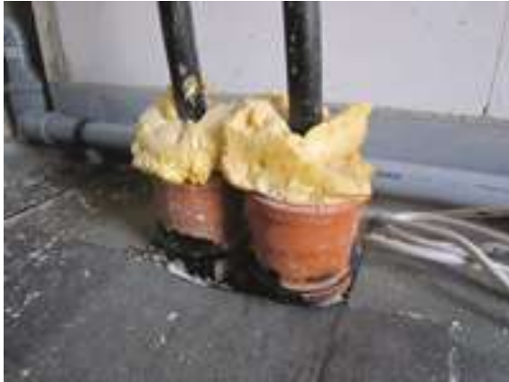
Bild 4: Nicht fachgerecht abgedichtete KG-Rohre*
