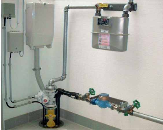
Bild 9: Fertig installierte Mehrspartenhauseinführung* * Bildquelle: Fachverband Hauseinführungen für Rohre und Kabel (FHRK)
